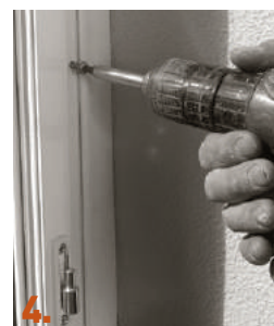
4. Fixation du nouveau dormant par vérins réglables ou par vissage en applique et réalisation d'une étanchéité périmétrale.
